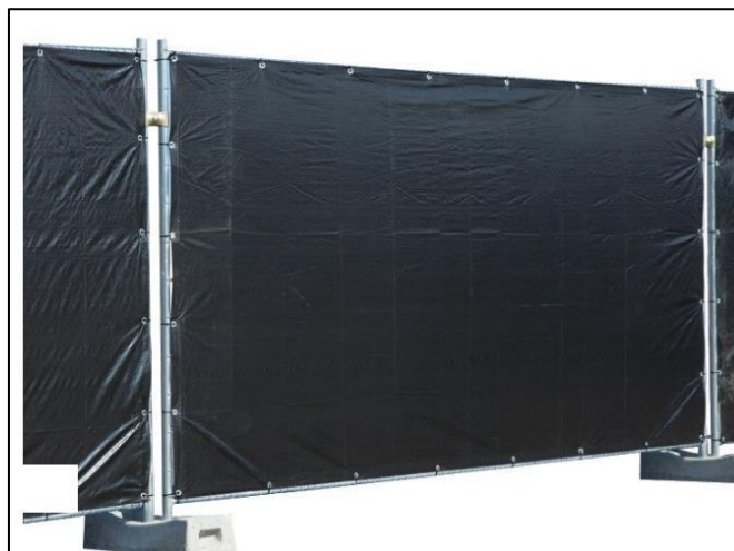
Figura 18: esempio di barriera antipolvere
